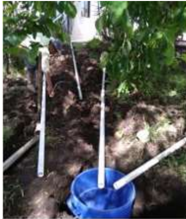
Figura 3.1 Separación de tuberías en las viviendas
