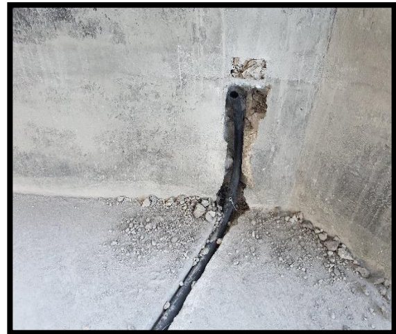
Figura 3.16 Proceso de picado para colocación de la caja y manguera del cableado
