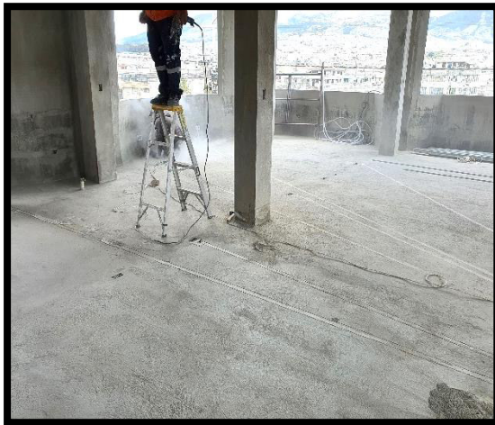
Figura 3.17 Señalización del cableado
