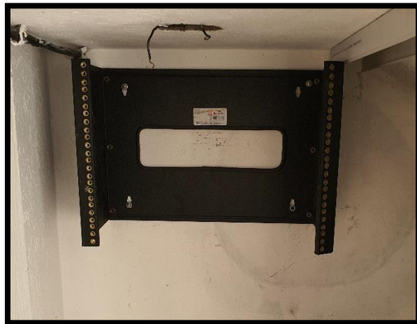
Figura 3.25 Rack instalado en el cuarto de telecomunicaciones
