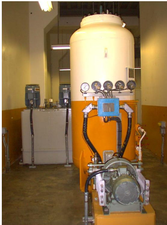
Figura 1.21. Tanque de presión aire/aceite
