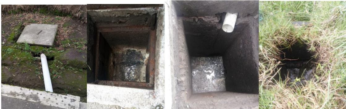
Figura 11. Pozos de revisión y vertedero a cielo abierto
