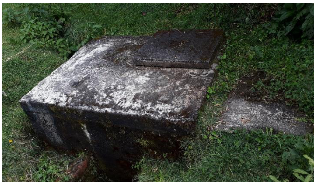
Figura 20. Tanque de captación de la vertiente 2.
