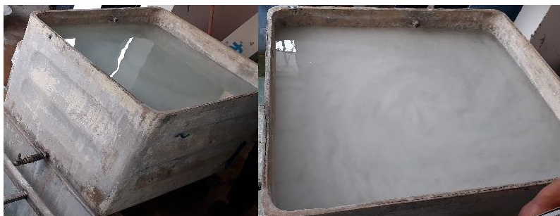
Figura 18. Tanque con solución madre de cloro.
