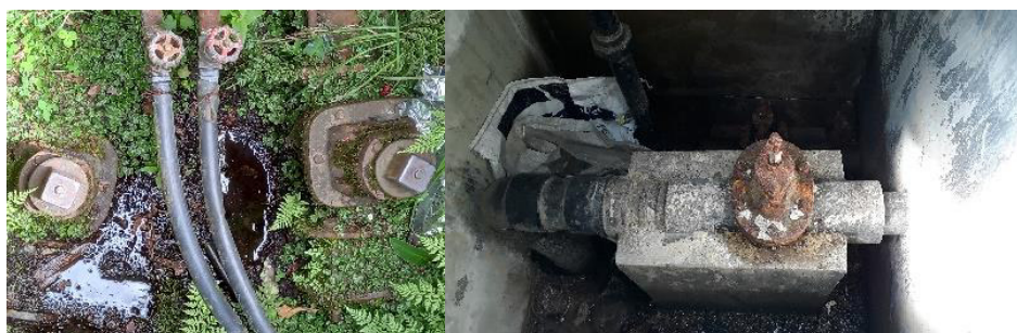
Figura 21. Válvulas de control fuera de funcionamiento.
