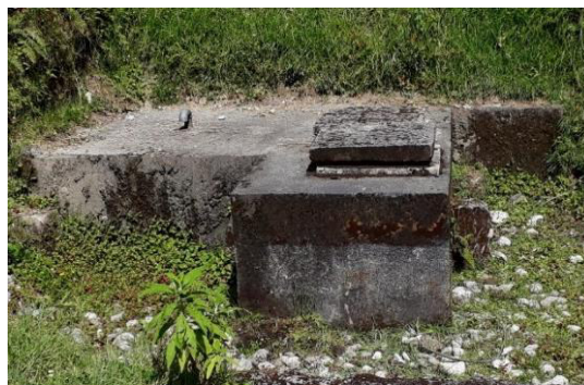
Figura 19. Tanque de captación de la vertiente 1.
