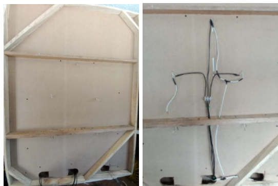
Figura 3.31 Colocación e Instalación de las lámparas inteligentes
