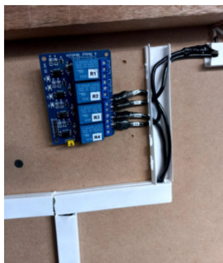
Figura 3.35 Instalación de lámparas halógena hacia el módulo relé
