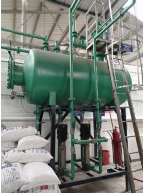
Figura 2.7. Tanque de retorno de condensado y alimentación de calderas. (fuente: propia)
