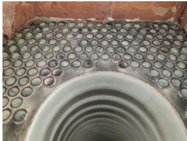
Figura 2.6. Tubos de fuego y hogar de la caldera. (fuente: propia)
