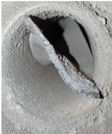
Figura 2.26. Turbuladores con ligero deterioro después de 2 meses de instalación. (fuente: propia)
