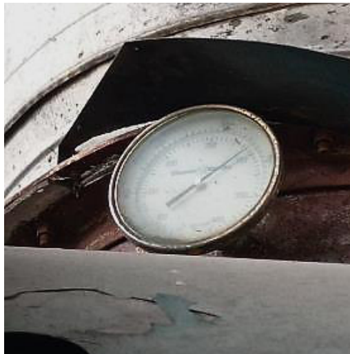
Figura 2.5. Dial del termómetro ubicado a la salida de los gases de chimenea (300 °C) . (fuente: propia)
