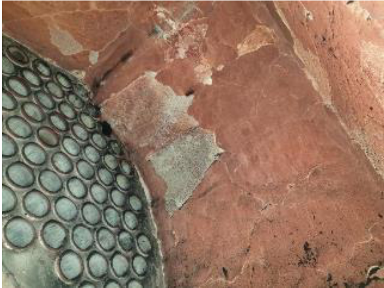
Figura 2.11. Espejo posterior, refractario en mal estado. (fuente: Reylacteos C.L. "Mantenimiento anual 2020")
