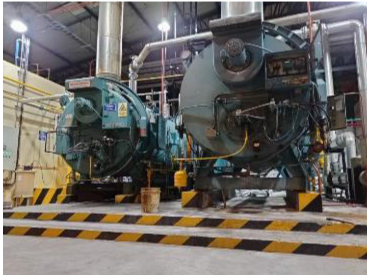
Figura 2.2. Caldera Cleaver Brooks 250 BHP (izq.) y caldera ABCO 350 BHP (der.). (fuente: propia)
