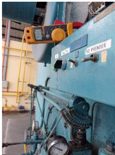
Figura 2.20. Medición de amperaje del quemador. (fuente: propia)
