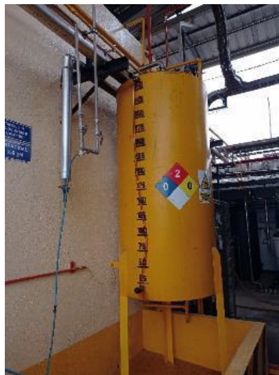
Figura 2.10. Tanque diario de 350 galones. (fuente: propia)
