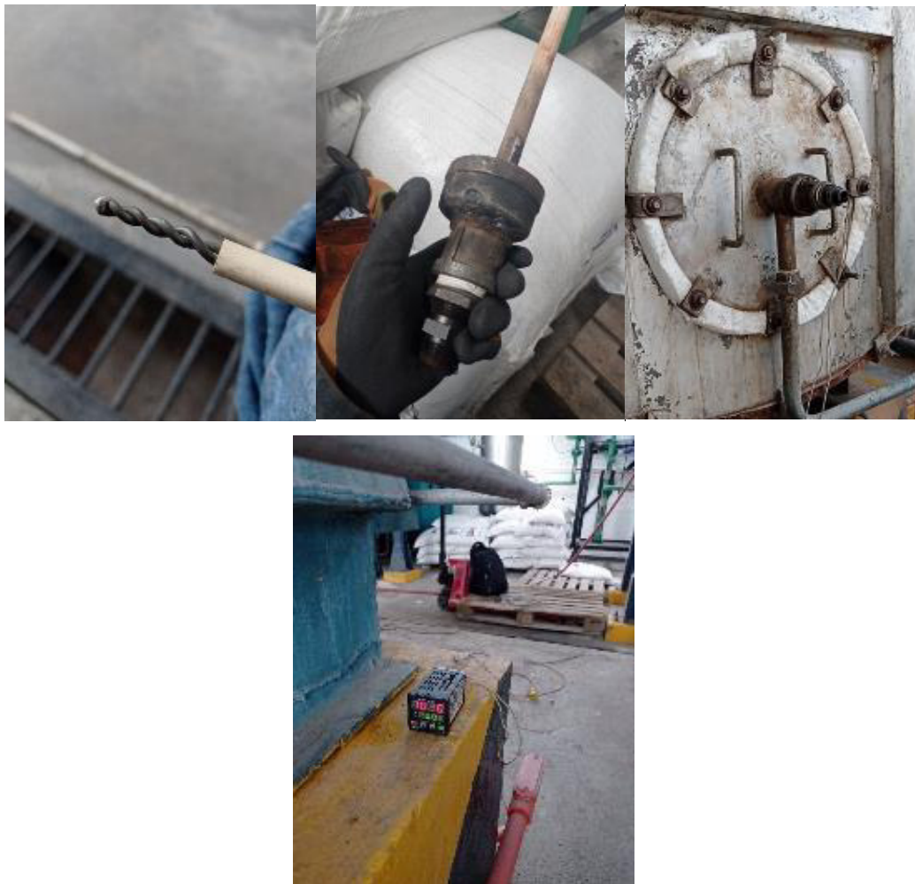
Figura 2.21. Termocupla tipo K con pozo cerámico adaptada en el tapón y controlador. (fuente: propia)
