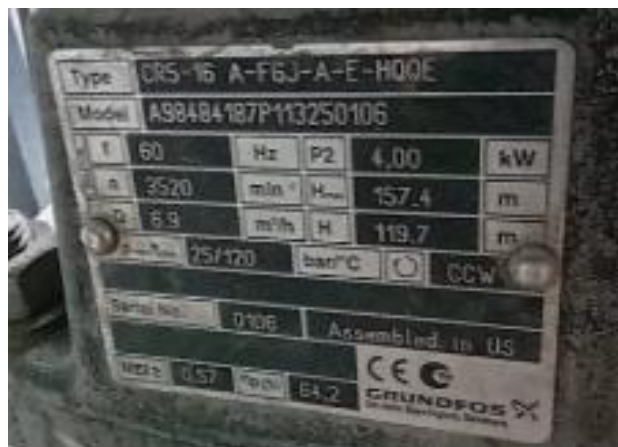
Figura 2.8. Placa de datos de la bomba de agua de ingreso a la caldera ABCO. (fuente: propia)
