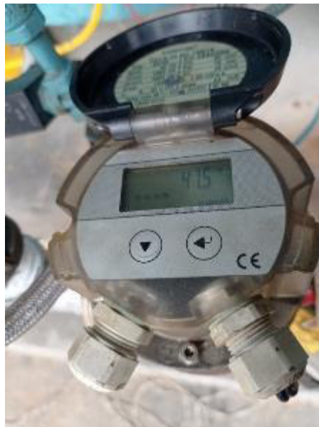
Figura 5.6. Caudalímetro instalado en la línea de combustible. (fuente: propia)
