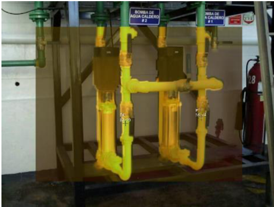
Figura 5.2. Temperatura de bomba de suministro de agua ABCO (izq). (fuente: propia)
