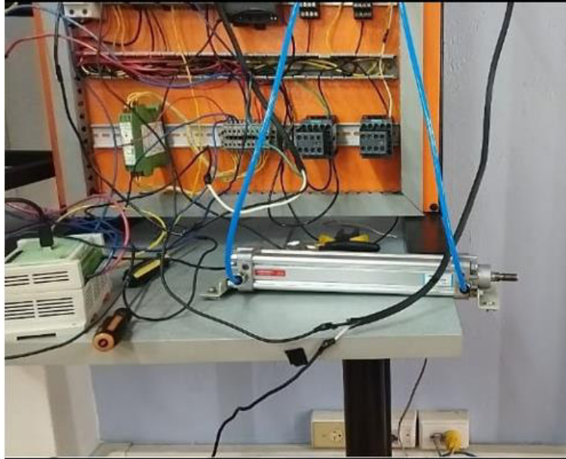
Figura 3.16 Prueba de encendido del actuador neumático
