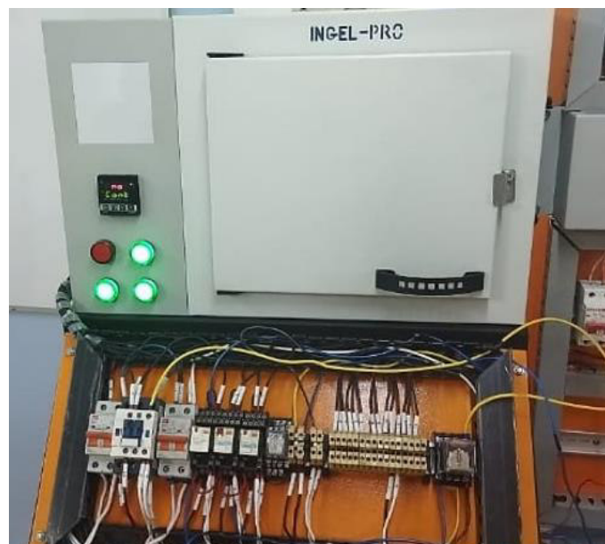
Figura 3.26 Luz indicadora del encendido de los ventiladores
