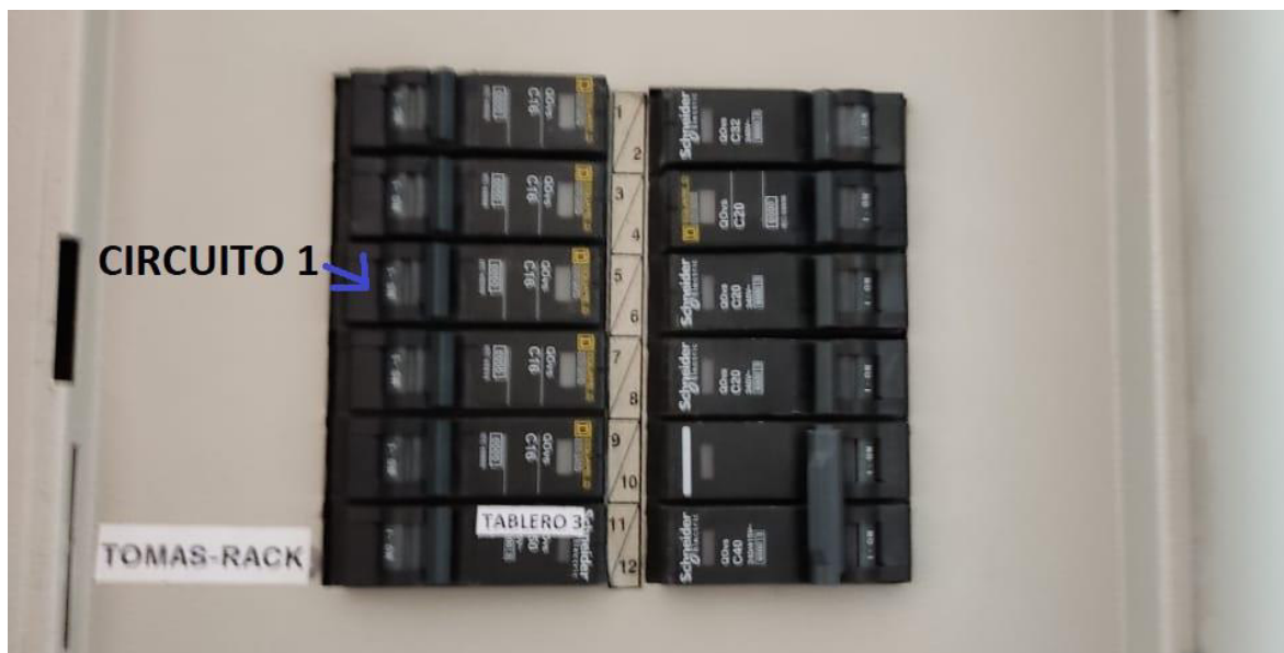
Figura 3.6. Subtablero de alimentación del laboratorio 15.
