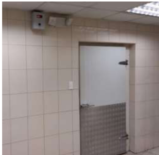
Figura 3-15 Cámara frigorífica vista externa
