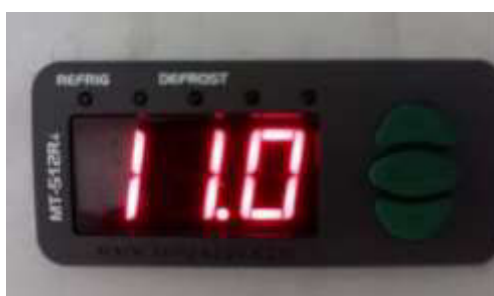
Figura 3-17 SET POINT de temperatura en cámara frigorífica
