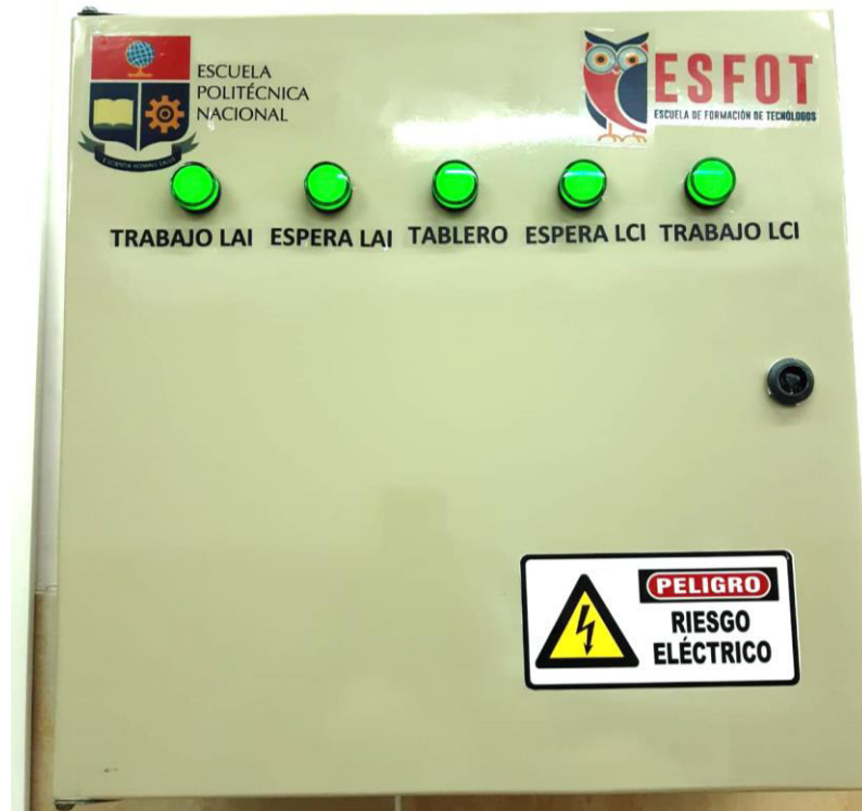
Figura 2. 7. Luces indicadoras disponibles en el tablero de control.
