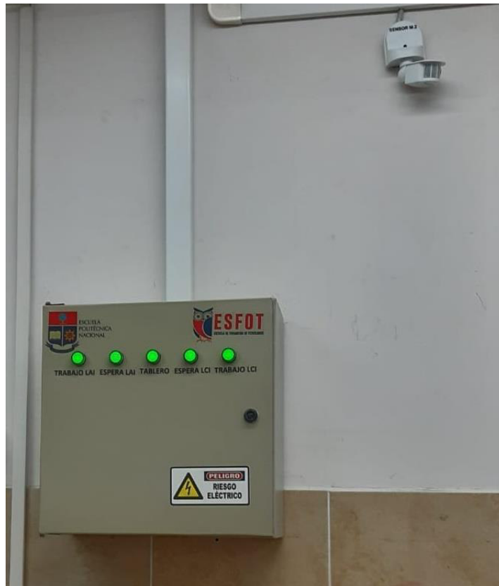
Figura 2. 8. Ubicación del tablero de control de luminarias.
