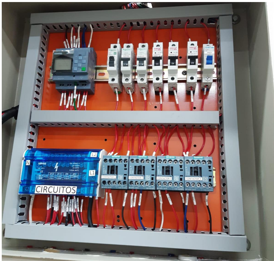
Figura 2. 6. Componentes electromecánicos dentro del tablero de control.
