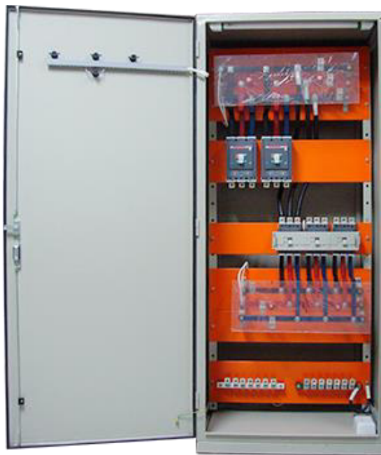
Figura 1. 2. Tablero eléctrico de control [5].
