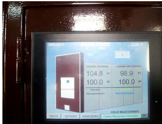
Figura 27. Tablero táctil. Control con tablero táctil.
