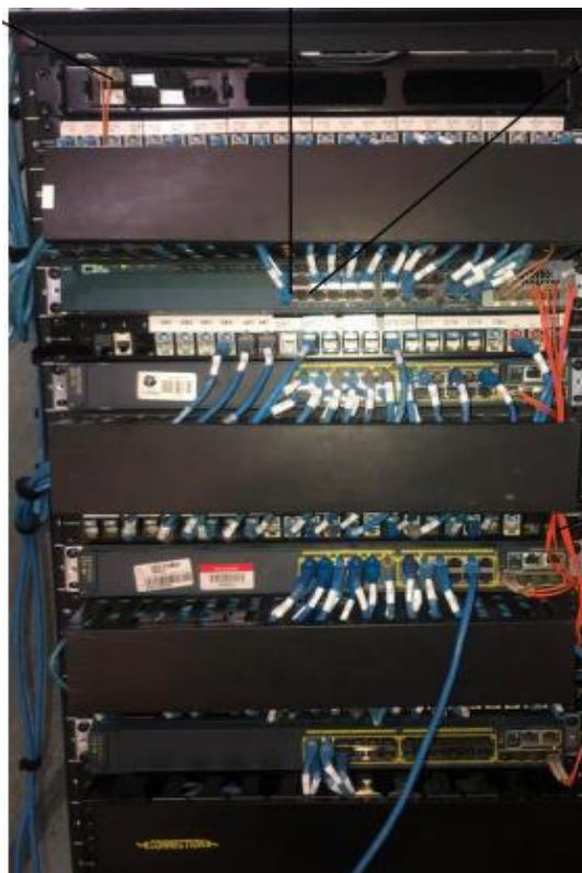
Figura 2.4. Cableado del rack principal del Ministerio del Ambiente.
