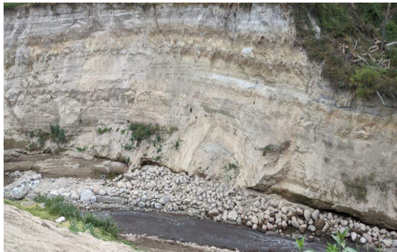
Figura 1.2 Fotografías con distintas perspectivas que muestran el estado erosivo de la Quebrada Carretas. Superior) Viviendas al borde de la ladera de la Quebrada Carretas fotografía tomada: 15-12-2022. Media) Ubicación de las viviendas respecto al borde de Quebrada Carretas fotografía
