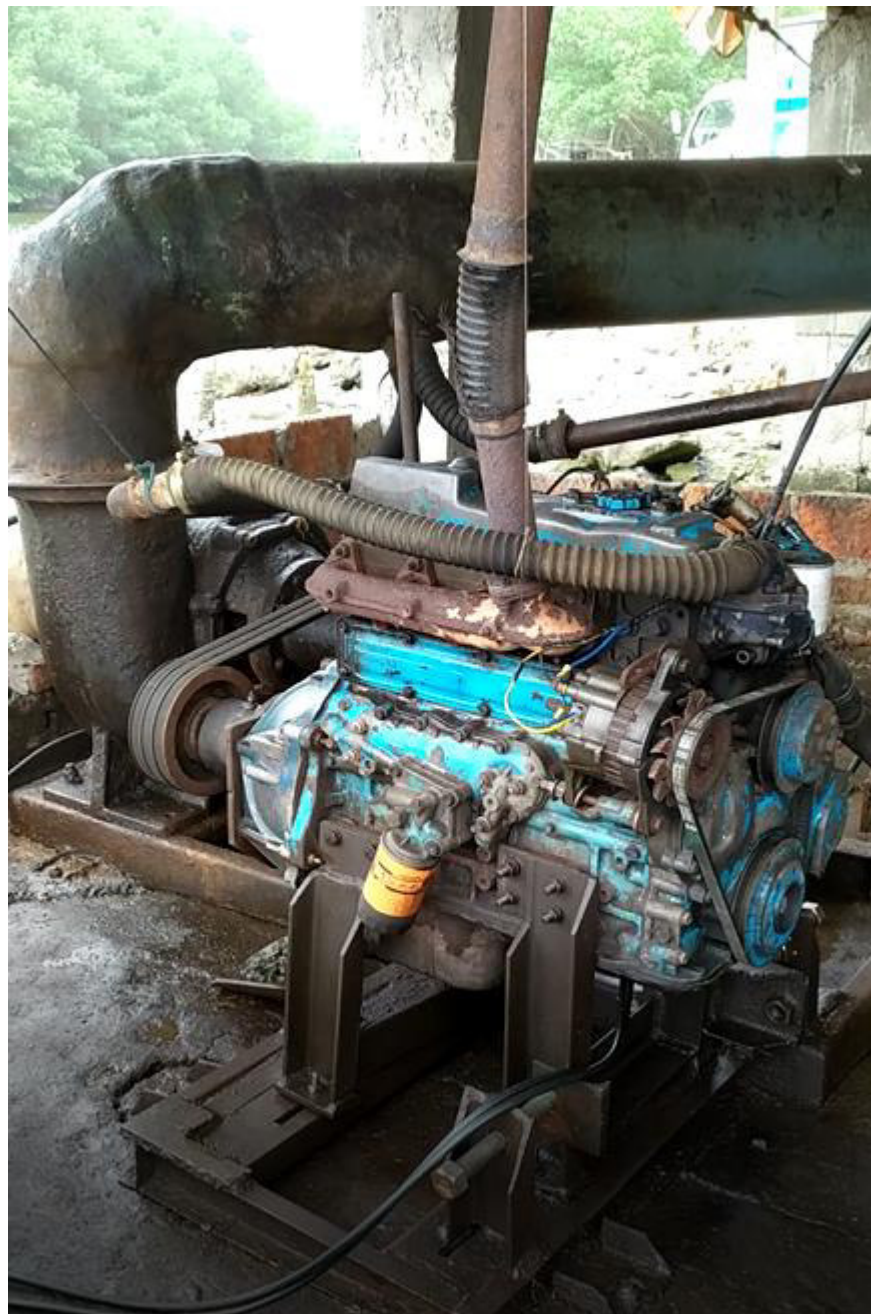
Bomba de extracción de agua
