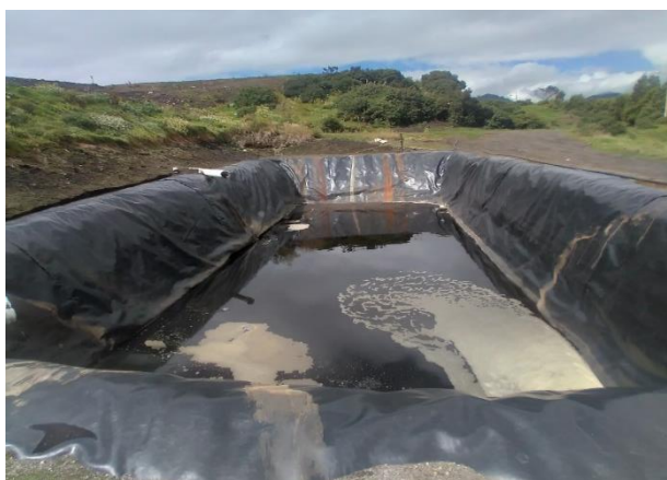
Figura 11. Vista en planta de la piscina N° 1 de lixiviado
