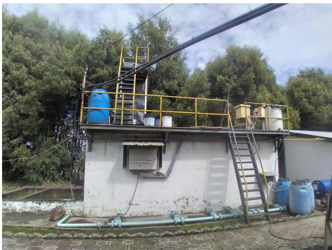
Figura 13. Planta de tratamiento de lixivados
