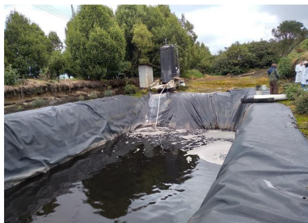
Figura 12. Vista en planta de la piscina N° 2 de lixiviado
