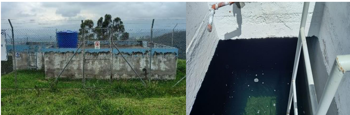
Figura 9 Tanque de cloración dos
