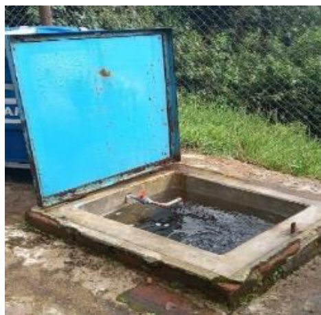
Figura 7 Tanque de cloración uno
