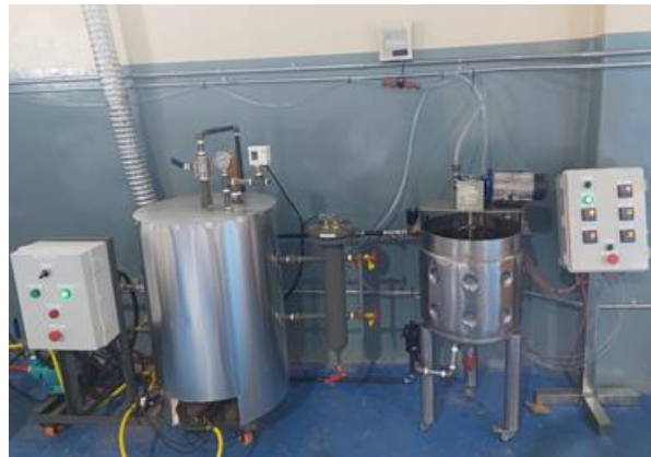
Figura 3.14. Instalación completa del equipo. Fuente: (propia)
