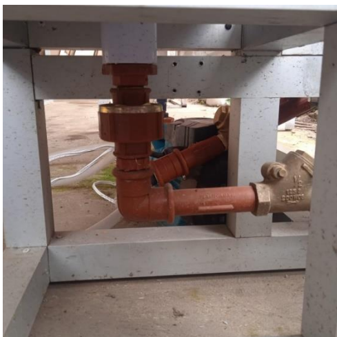
Figura 5.7 Unión universal conectada al tanque
