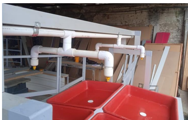
Figura 4.4 Tubería de roció
