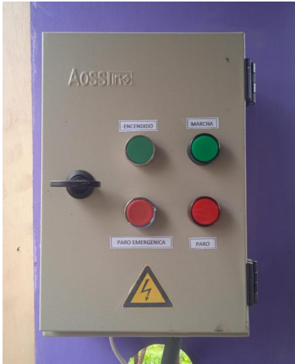
Figura 4.6 - Tablero de control (Fachada externa)
