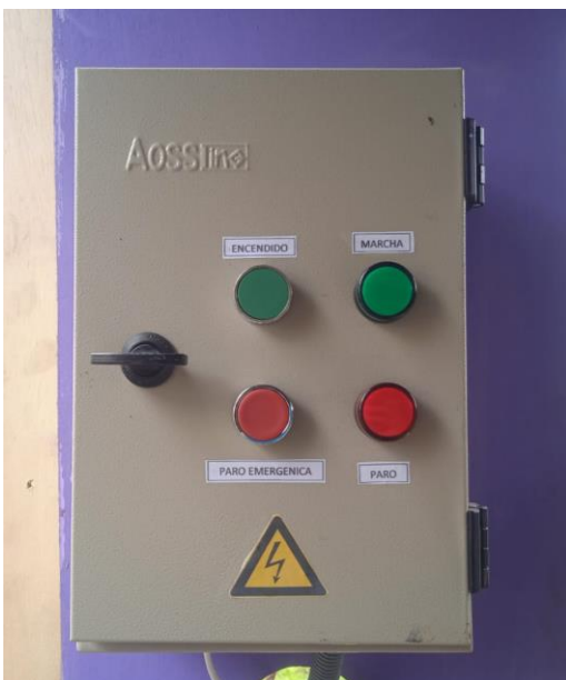
Figura 2.9 Tablero de control - Fachada exterior
