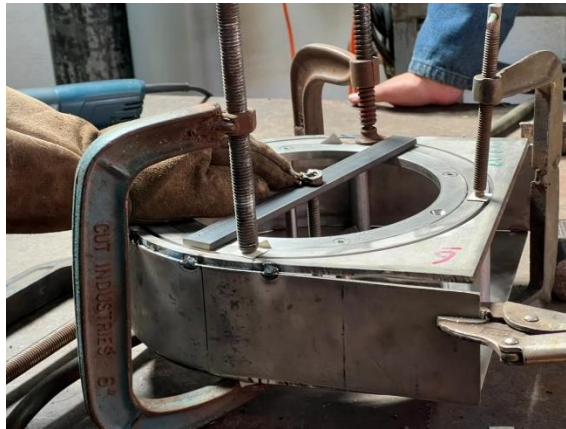
Figura 32. Sujeción para puntos de suelda en la cámara de molienda.
