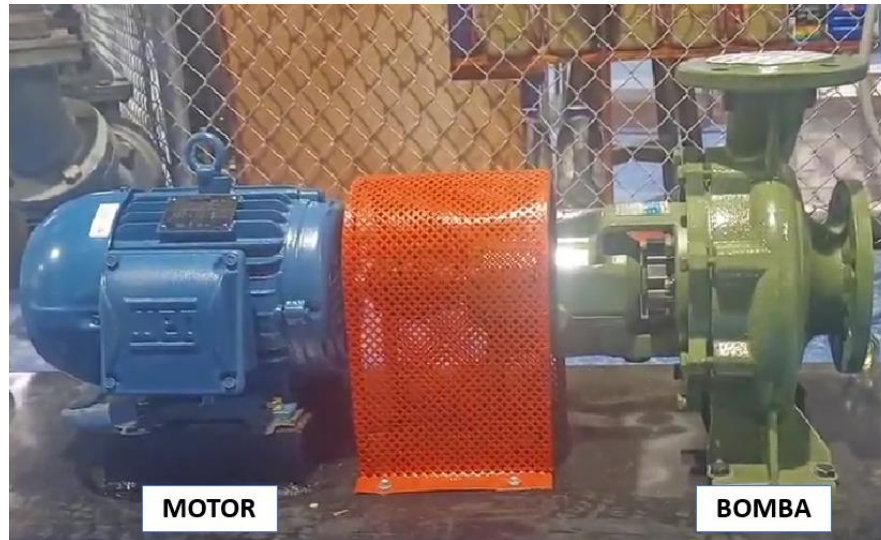
Figura 2.2 Bomba SAER NCB 65/200N A ubicada en el laboratorio de turbomáquinas de la Escuela Politécnica Nacional [fuente propia]
