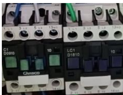
Figura 2.16. Contactores de 9[A] y 18[A]
