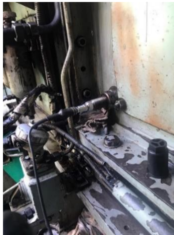
Figura 2.10. Acelerómetro ubicado en uno de los espárragos laterales de los cojinetes
