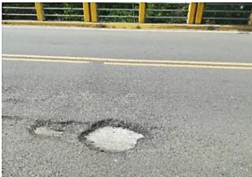
Figura 212. Capa de rodadura en mal estado del puente sobre el Río Mocora.
