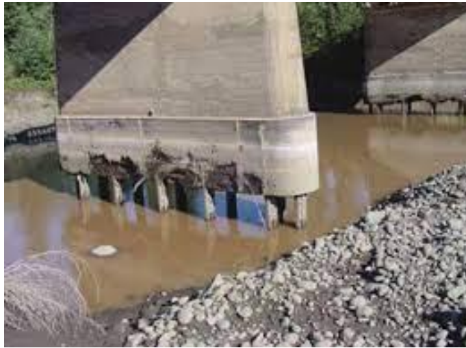
Figura 27. Socavación en pila del puente sobre el Río Achiote.
