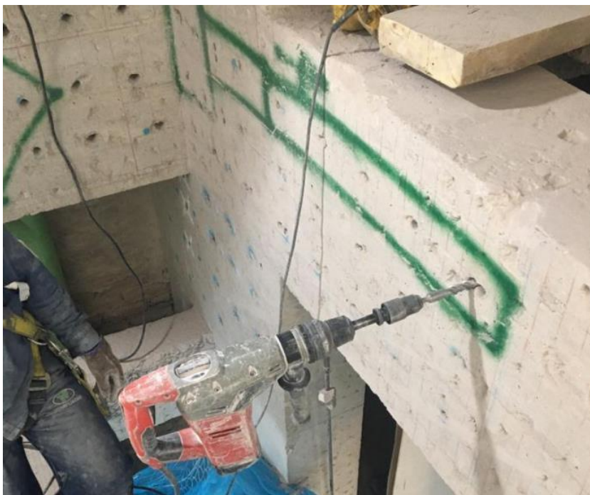
Figura 188. Perforaciones continuas en viga de hormigón.
