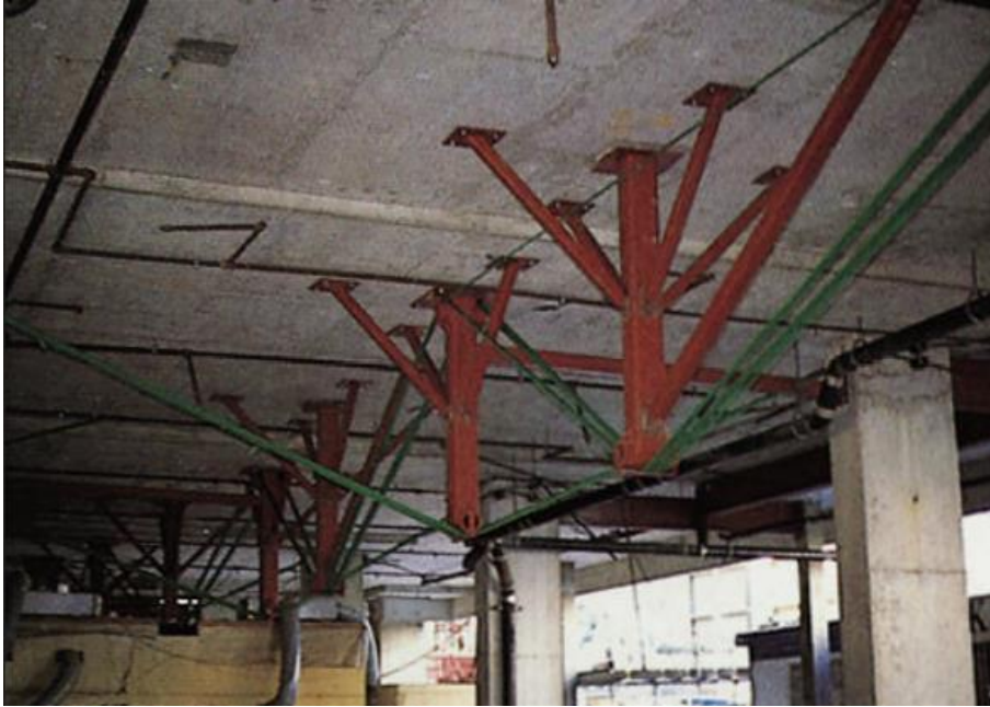
Figura 55. Tendones y apoyos metálicos bajo una losa.
