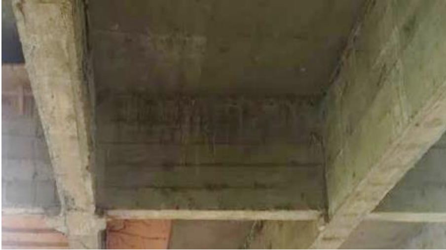
Figura 44. Vista del estado de los diafragmas del puente sobre el Río Mocora.
