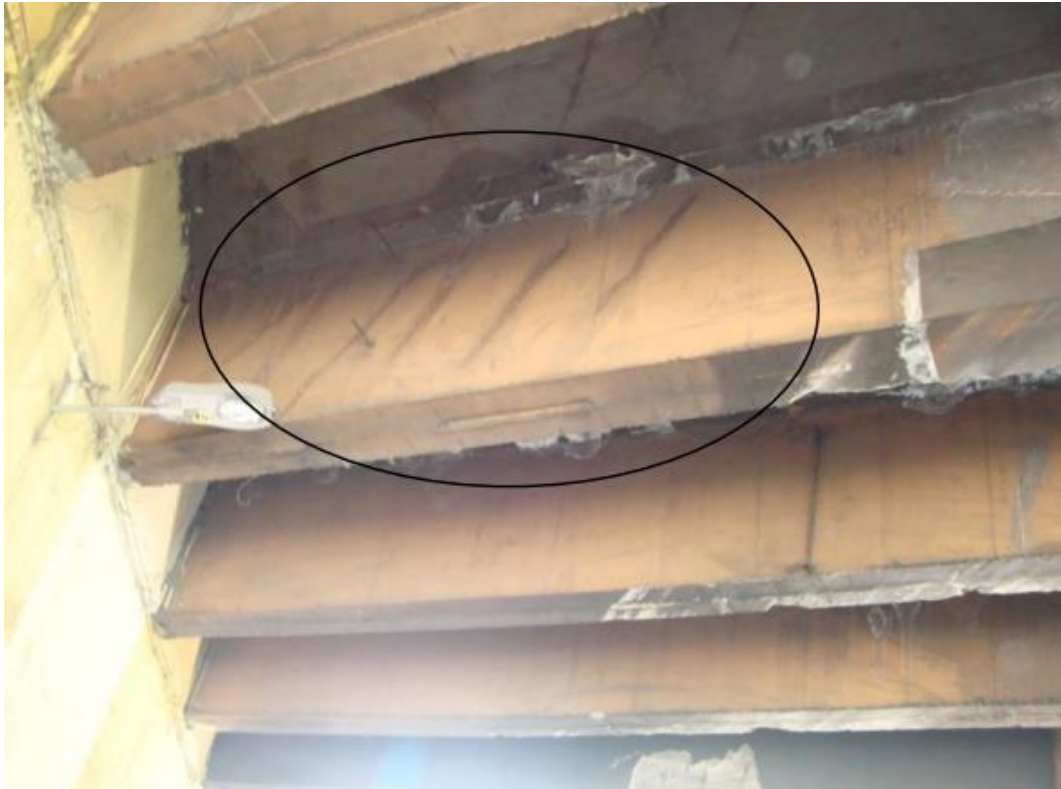
Figura 30. Fisuras por corte presentes en las cercanías de los apoyos de la viga del puente de Puengasí.
