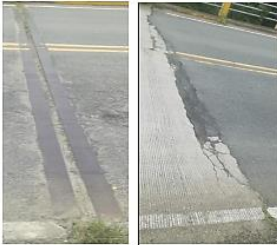
Figura 213. Juntas de expansión cubiertas por capa asfáltica del puente sobre el Río Mocora que deben ser inspeccionadas con regularidad.
