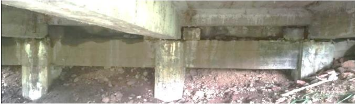
Figura 46. Vista del estado de los estribos del puente sobre el Río Mocora.
