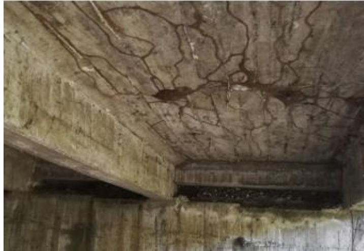
Figura 42. Vista de las fisuras del tablero del puente sobre el río Mocora.
