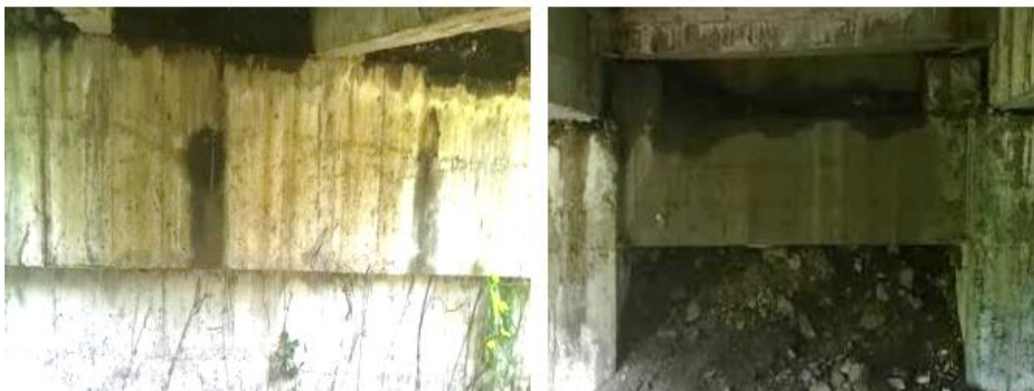
Figura 45. Vista del estado de los cabezales del puente sobre el río Mocora.
