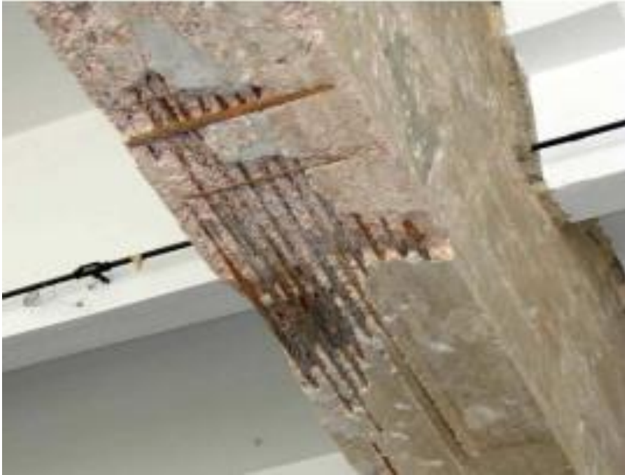
Figura 25. Acero corroído en el puente sobre el río Tomebamba en Cuenca.
