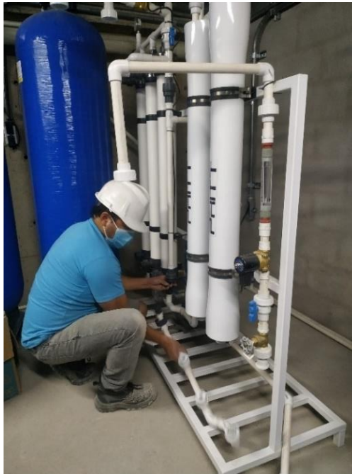
Figura 2.27. Ensamblaje del rack.
