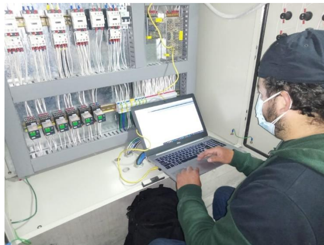
Figura 2.32. Programación del PLC.
