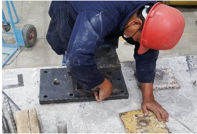
Figura 67. Ubicación de los agujeros para la instalación de pernos de anclaje en la losa de cimentación. Fuente: Elaborado por Carlos Gallegos.
