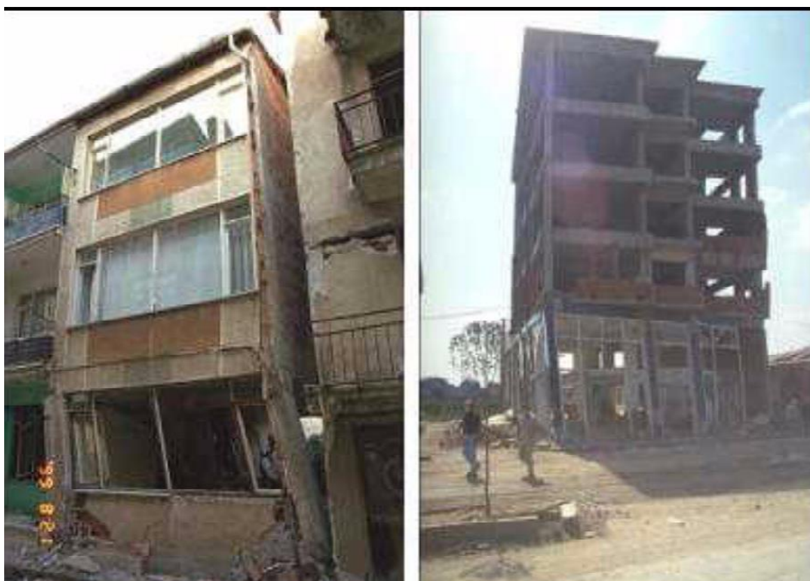
Figura 22. Fallo de un edificio por piso blando (derivadas excesivas en la planta baja). Fuente: (Bonett Díaz, 2003).
