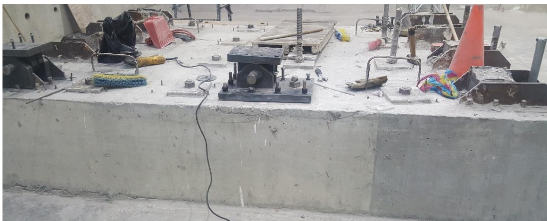
Figura 65. Losa de cimentación con los apoyos instalados. Fuente: Elaborado por Carlos Gallegos.
