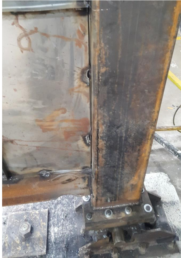
Figura 125. Falla de la soldadura en el muro 3. Fuente: Elaborado por Carlos Gallegos.
