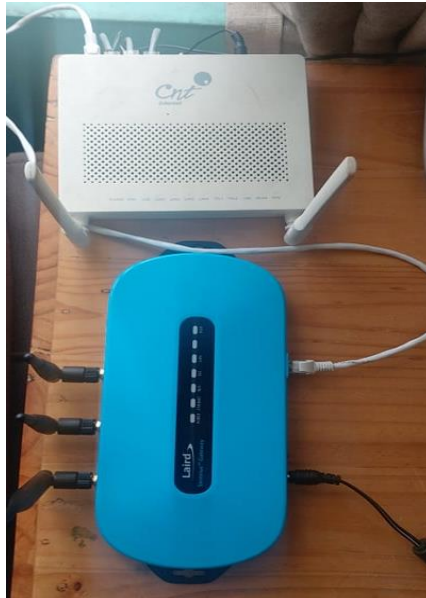
Figura 2.12 Energización de gateway y conexión a la red local.
