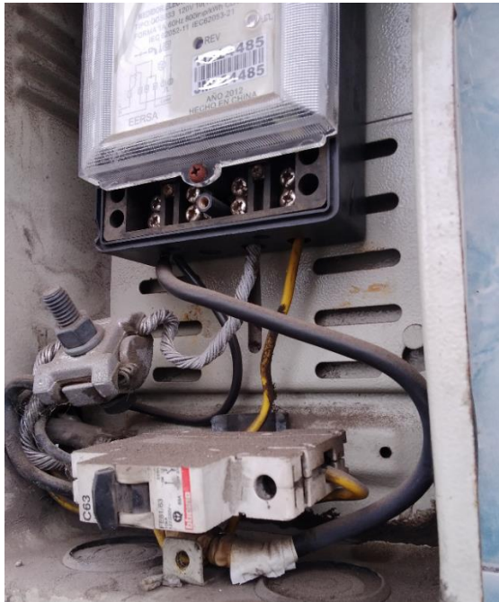
Figura 6.14 Fase sale directo de la bornera al térmico sin pasar por el contador de energía
