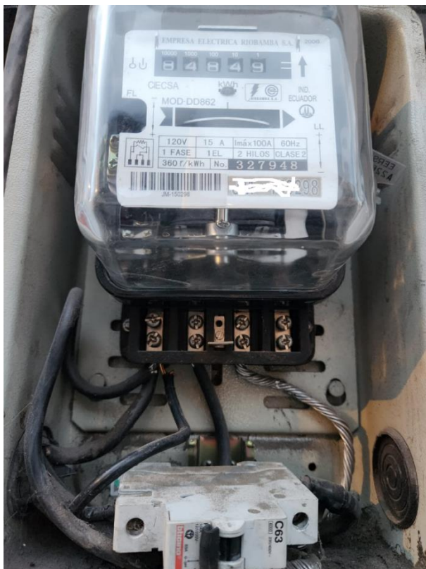
Figura 6.15 Fase sale directo de la bornera al térmico sin pasar por el contador de energía
