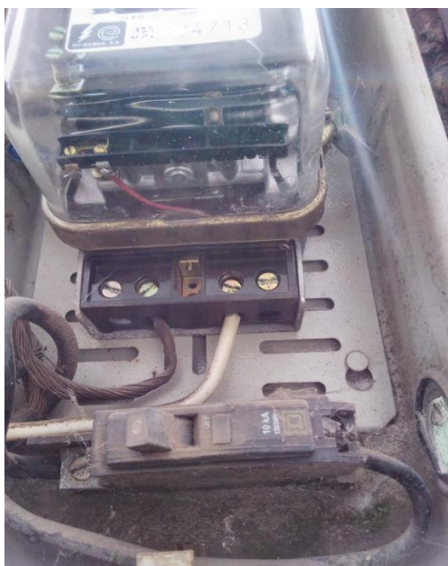
Figura 6.13 Fase entra directo al térmico sin pasar por el contador de energía
