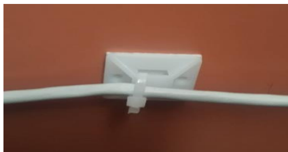
Figura 3.44 Fijación del cable Ethernet con la base adhesiva cuadrada y amarra plástica
