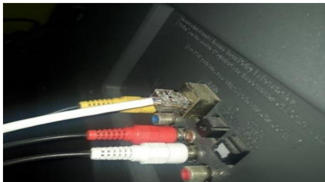
Figura 3.40 Puerto Ethernet de la televisión del segundo piso
