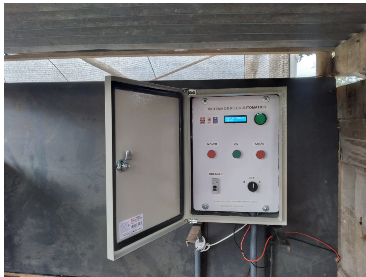
Figura 2.30 Tablero instalado y funcionando
