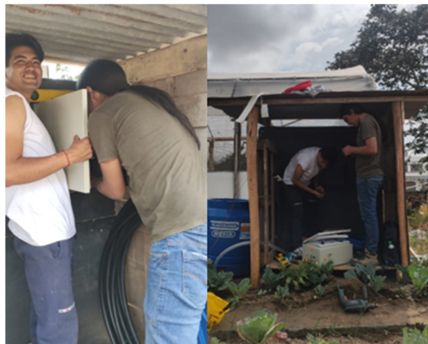
Figura 2.28 Ubicación del tablero en la caseta
