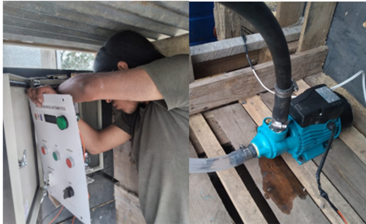
Figura 2.29 Bomba instalada y unión eléctrica-mecánica
