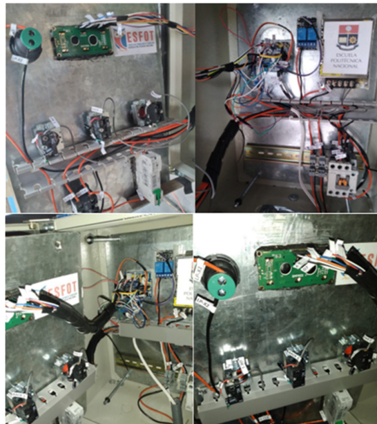
Figura 2.26 Interior del tablero de control
