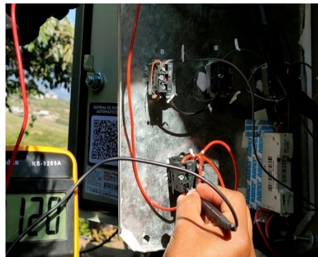
Figura 3.2. Prueba de tensión en el tablero eléctrico
