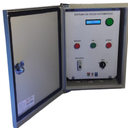
Figura 1.5 Tablero eléctrico del sistema de riego
