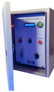
Figura 2.18. Gabinete eléctrico del sistema de riego
