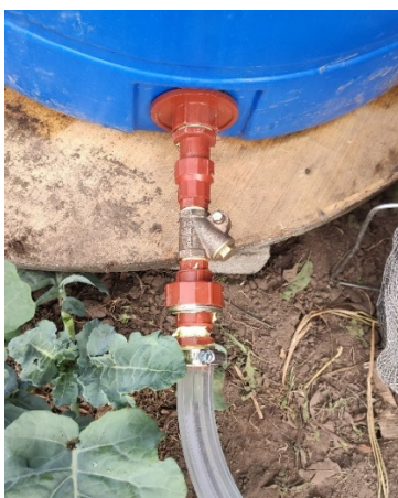
Figura 2.21. Instalación de válvula antirretorno entre el tanque y la bomba
