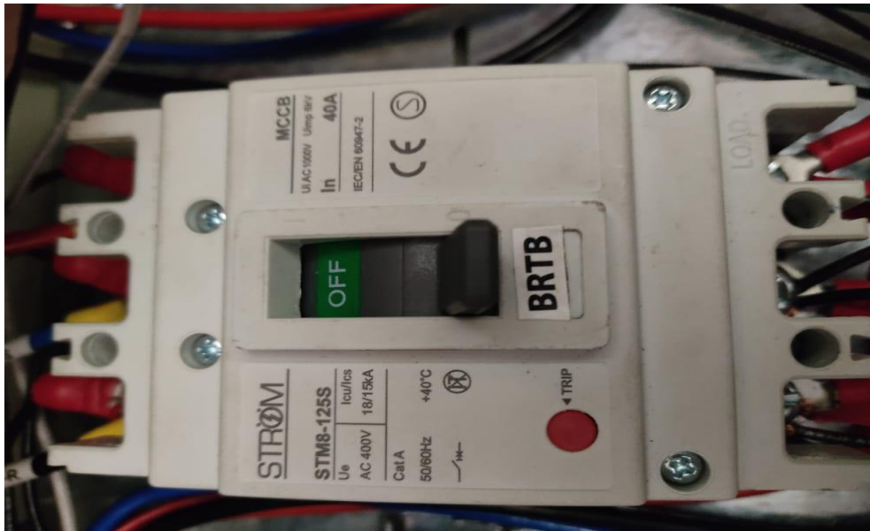
Figura 3.2. Interruptor principal de 40(A) marca STROM.
