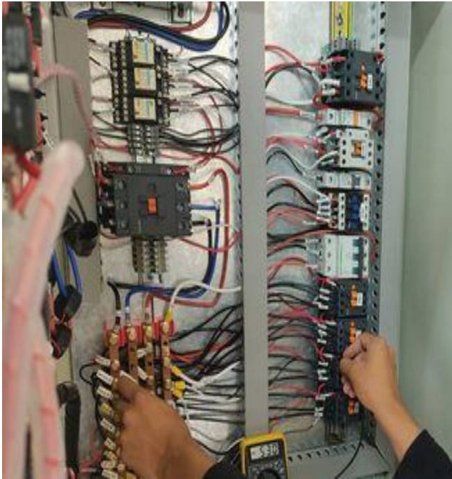
Figura 3.18. Etiquetado de contactores, cables y pulsadores. [8].
