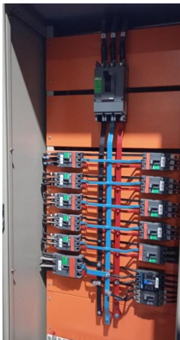
Figura 2: Tablero de distribución principal.
