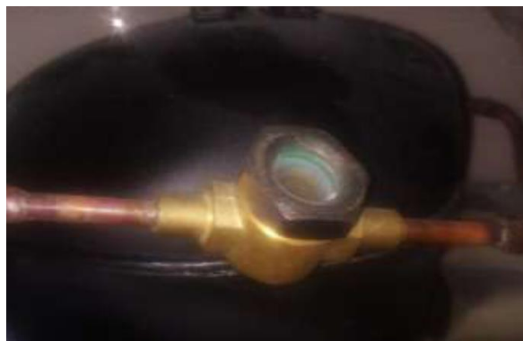
Figura 2.4 Visor del sistema de refrigeración, [8].
