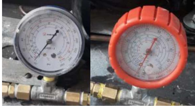
Figura 2.9 Manómetros del sistema de refrigeración, [8].
