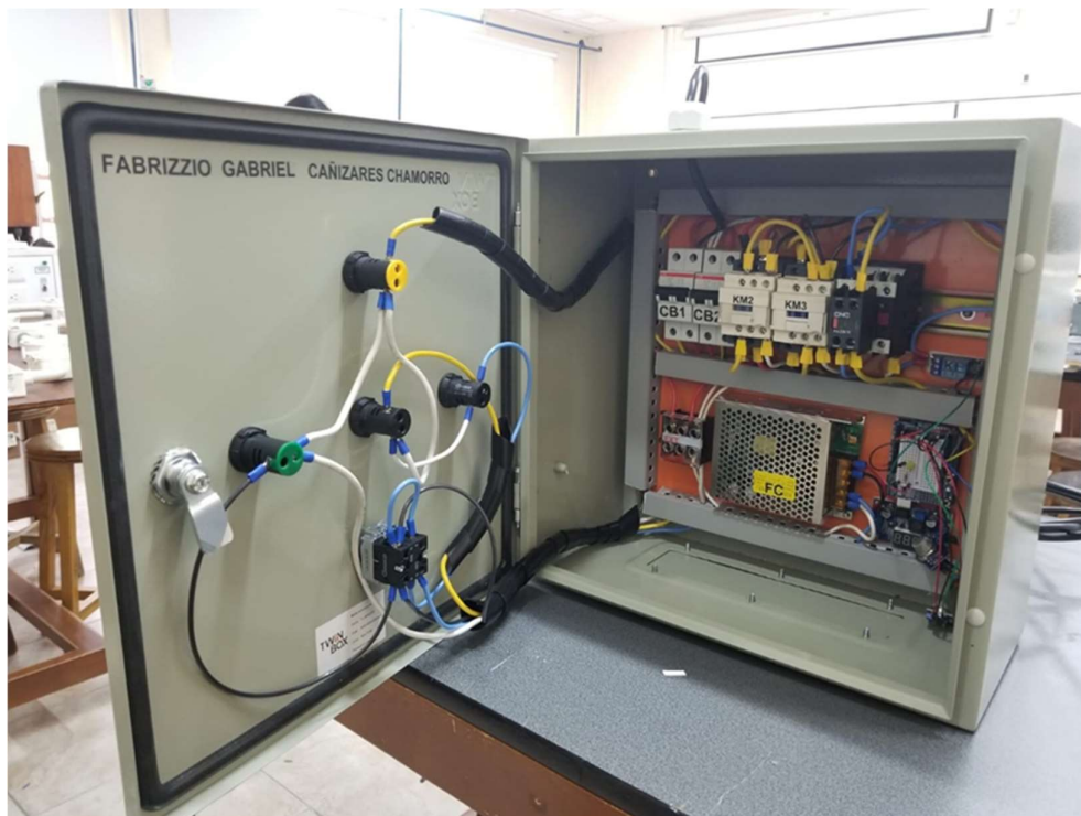
Figura 2.17 Vista interna final con conexión de luces.
