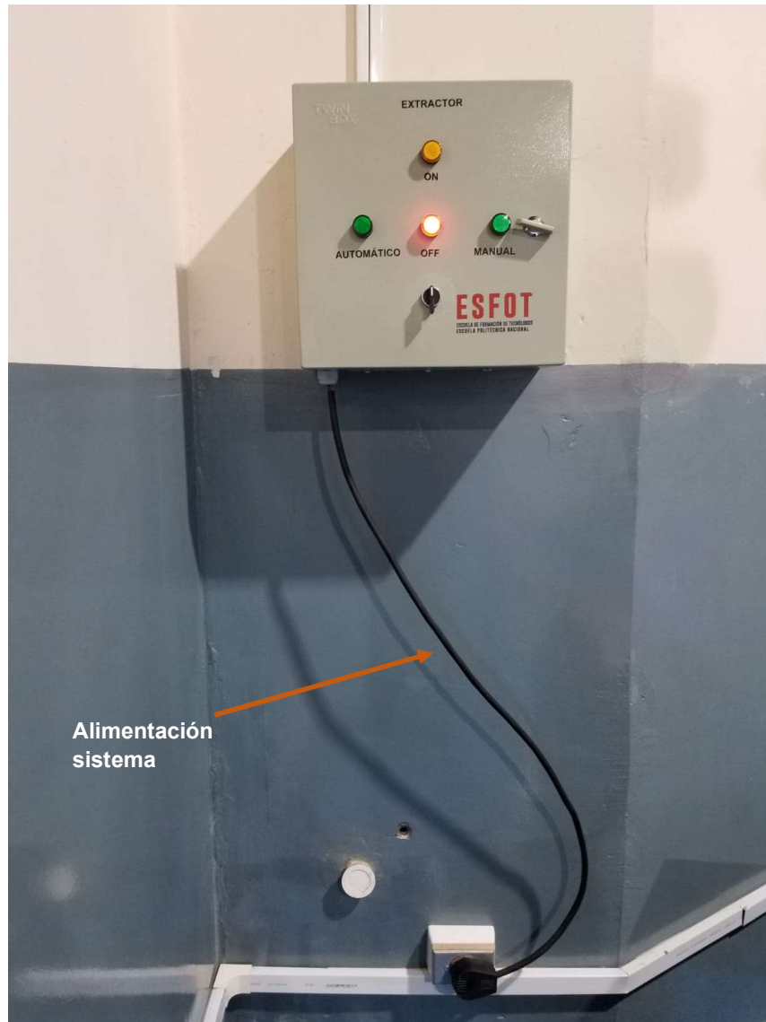
Figura 3.8 Montaje de tablero de control y protección de sistema de extracción en el Centro de Perfeccionamiento para el manejo de refrigerantes naturales.
