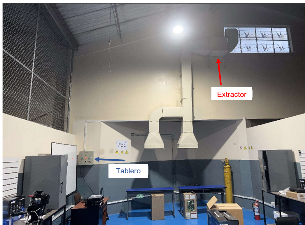
Figura 3.7 Implementación final de sistema eléctrico para activación de extractor en el Centro de Perfeccionamiento para el manejo de refrigerantes naturales.
