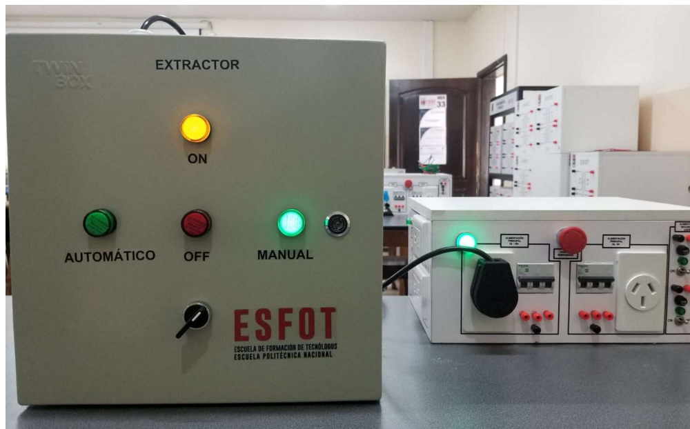
Figura 3.2 Comprobación de estado de Modo Manual.
