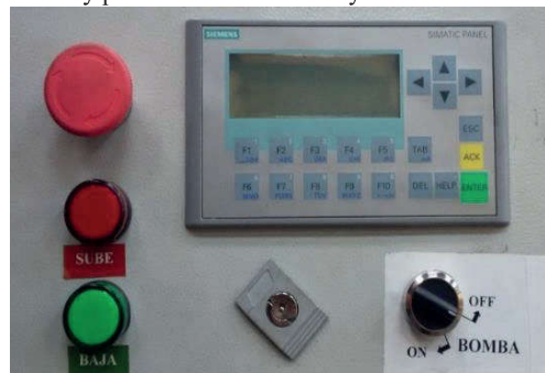
Figura 8: Tablero HMI con elementos de maniobra.
