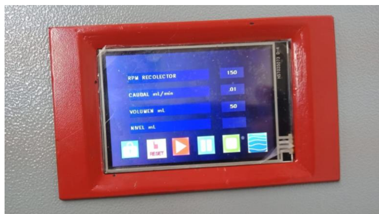
Figura 5. Panel de control. [Fuente: Propia]
