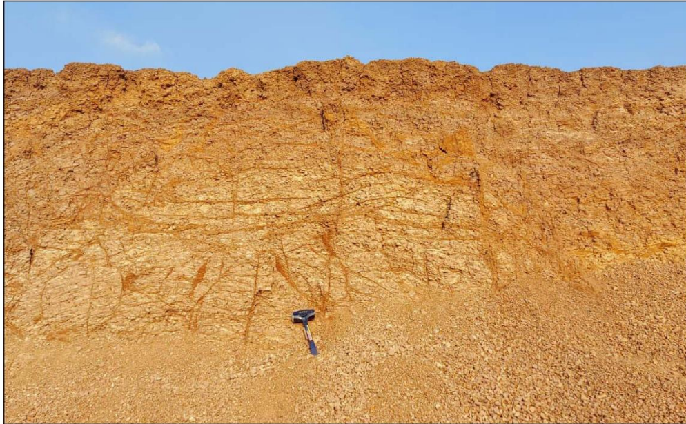
Figura 16 Varias fracturas cortan al estrato masivo de arena, estas fracturas se encuentran llenas de yeso y en ciertos casos de material silíceo (547919,4/9882154,2).
