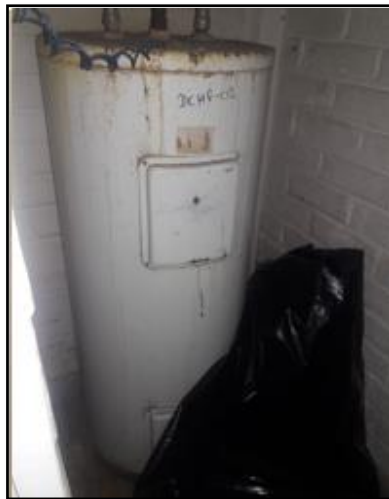
Figura 3.1. Calentador a gas de la piscina [27]
