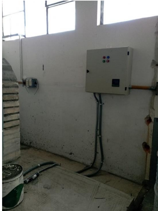
Figura 14. Tablero de fuerza y control [Fuente: Propia].
