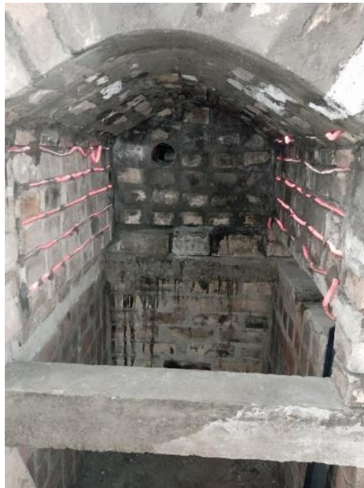
Figura 24. Resistencias eléctricas empotradas [Fuente: Propia].
