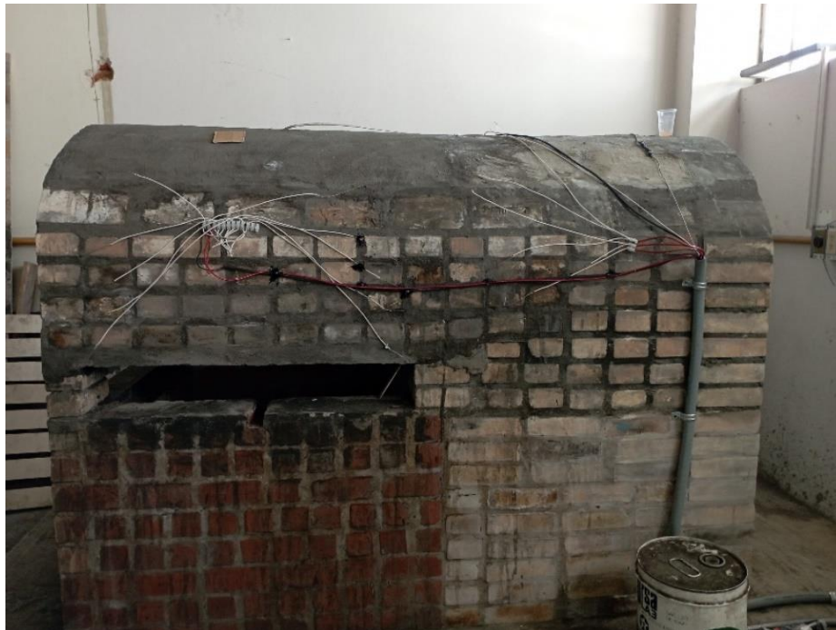
Figura 15. Conexión de resistencias en cámaras [Fuente: Propia].
