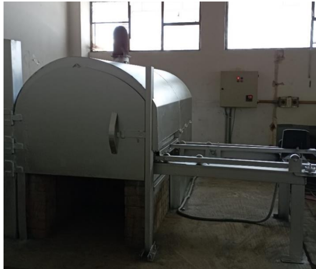
Figura 26. Pintura externa de horno incinerador [Fuente: Propia].
