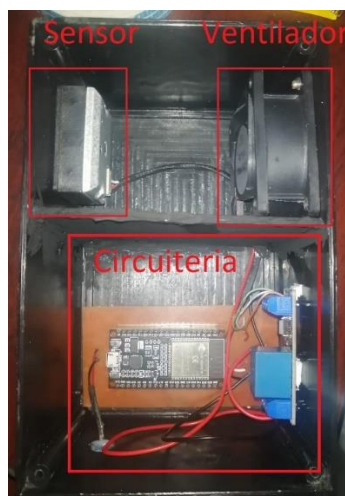
Figura 3.17 Montaje y ubicación de los componentes y módulos electrónicos en la caja plástica
