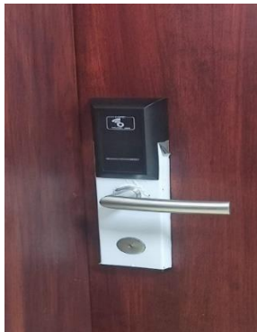
Figura 2.3. Cerradura con lector de proximidad (RF10)
