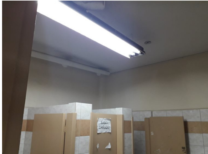
Figura 2.7. Lámparas fluorescentes instaladas en el baño de hombres del cuarto piso
