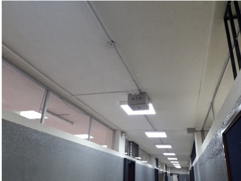
Figura 2.2. Paneles LED instalados en los pasillos del DFB
