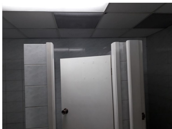
Figura 2.6. Falta de iluminación en SS. HH Hombres en el tercer piso
