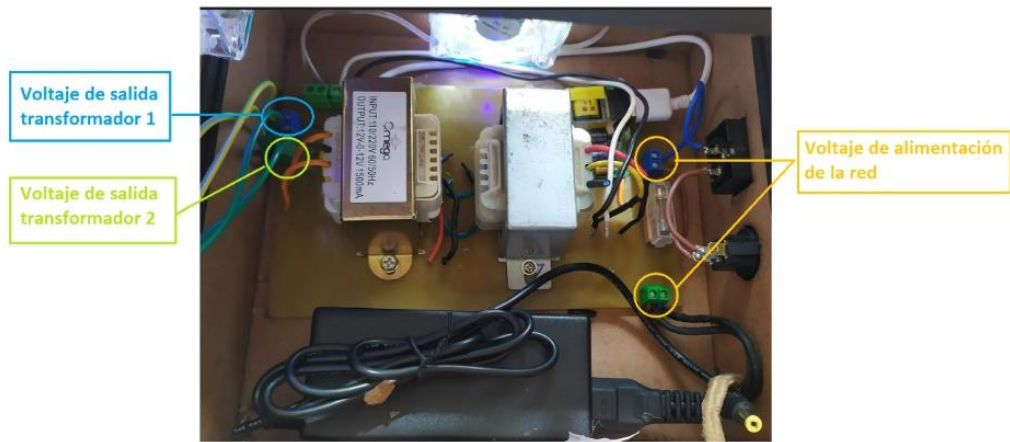
Figura 3.2 Puntos de medición de los voltajes de alimentación
