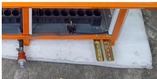
Figura 2.10. Soporte para la bomba presurizadora
