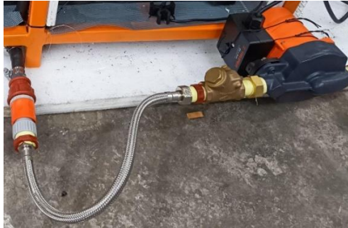
Figura 2.11. Conexión de la bomba con el sistema de riego.
