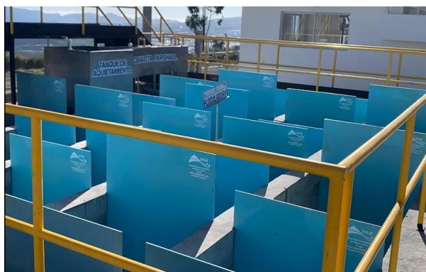
Figura 4. Floculador hidráulico de flujo vertical PTAP “Huayco Machay”
