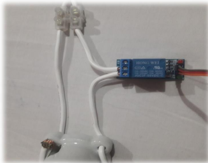
Figura 3.19. Relé conectado al foco
