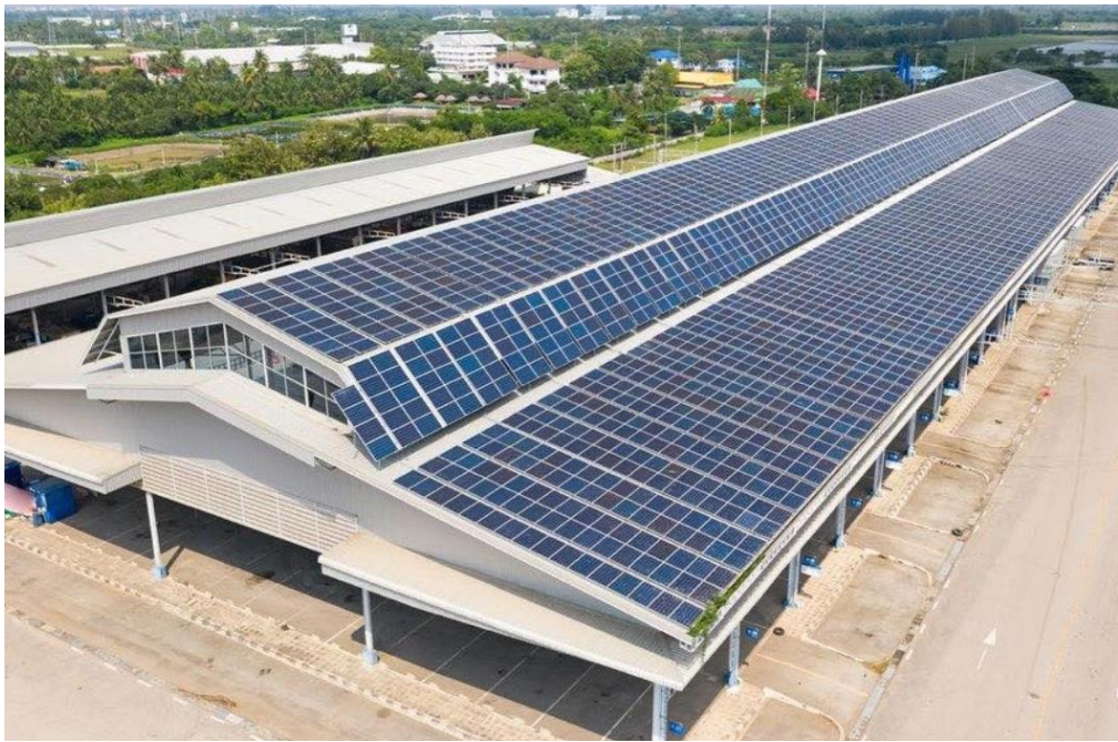
Figura 1.3. Ejemplo de la instalación de sistemas fotovoltaicos. Fuente: [23]
