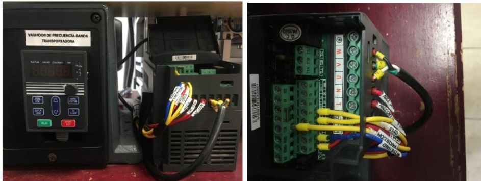
Figura 5.47. Etiquetas colocadas en el cableado del variador de frecuencia de la banda transportadora.
