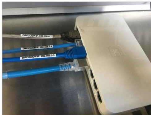
Figura 5.50. Etiquetas colocadas en los cables de red.
