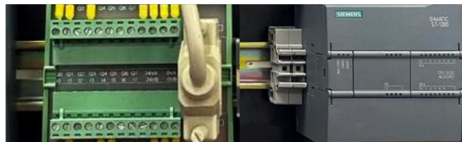
Figura 5.37. Posicionamiento para PLC S7-1200 y el módulo DB25 8E/8S en el panel de control.
