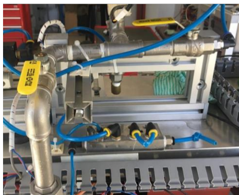
Figura 2.9. Sistema de tuberías.
