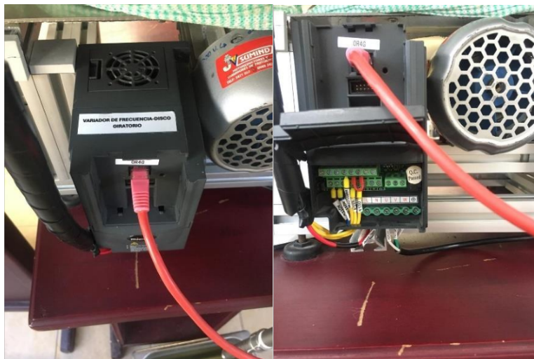
Figura 5.48. Etiquetas colocadas en el cableado del variador de frecuencia del disco giratorio.
