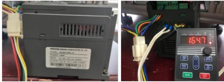
Figura 5.5. Variador de velocidad banda transportadora.
