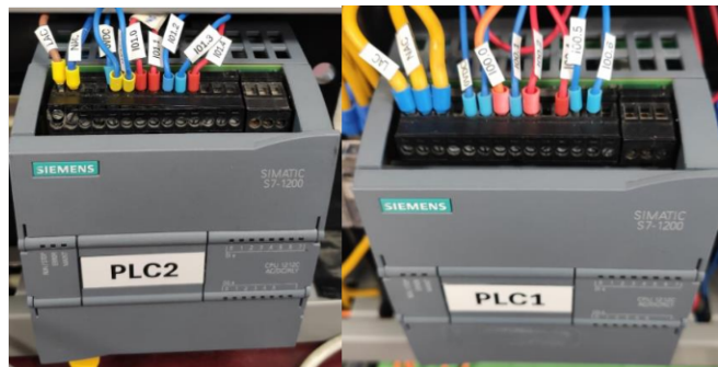
Figura 3.29. Etiquetado de los PLCs.
